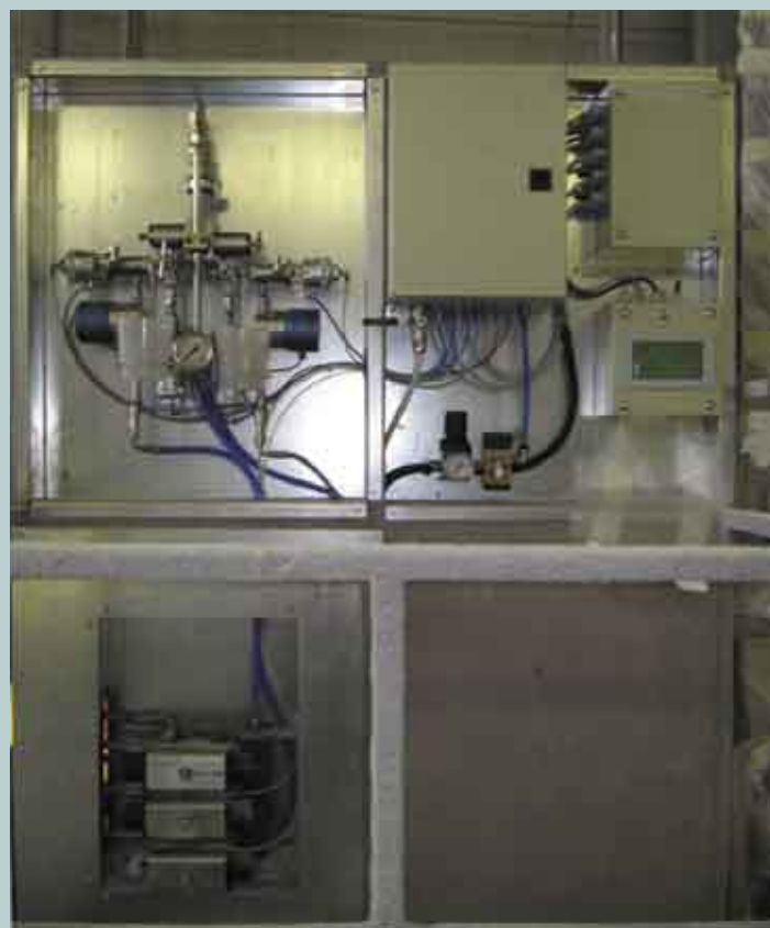
Fig. A - Uno dei “ paint lift ” con a bordo i sistemi di miscelazione e il tastierino “ touch screen ” per la gestione delle funzioni di competenza del verniciatore.
