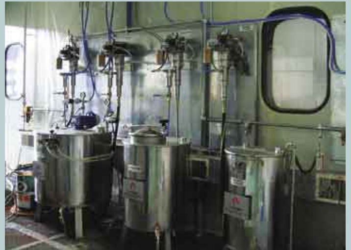
Fig. B - La centrale di vernice per le due cabine di verniciatura.
