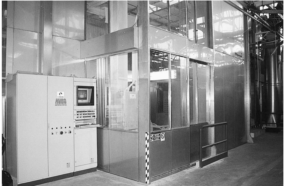
Fig. 7 - La cabina di applicazione. All'interno è visibile una parte del primo reciprocatore super regolabile. A sinistra, la centrale elettronica del sistema applicativo
