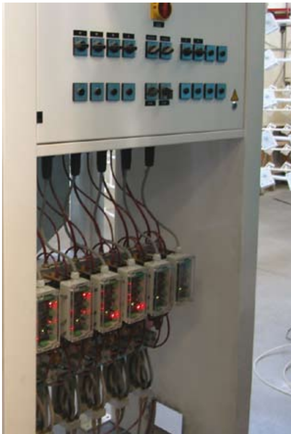
3 - Sopra le pompe airless di erogazione polvere alla Team Paints di Monticelli Brusati (BS).
